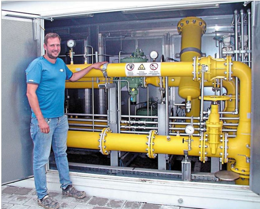
Von hier aus wird das Erdgas in Hengersberg verteilt: Ben Nadolny, Abteilungsleiter Gas der Gemeindlichen Werke, an der Ortsnetzstation.
